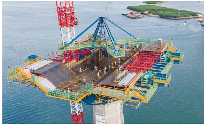
Figura 5: Equipo levantado y listo para la construcción de la cabeza de la pila
