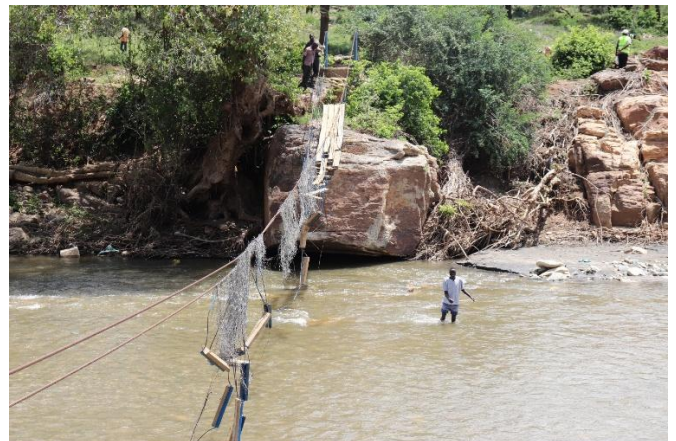
Figura 2: Puente peatonal dañado tras las inundaciones de 2019 - West Pokot
